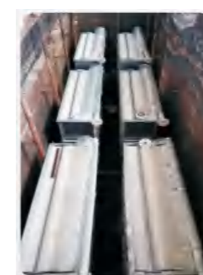
FMBR应用—300m³/d 天津医药废水处理
