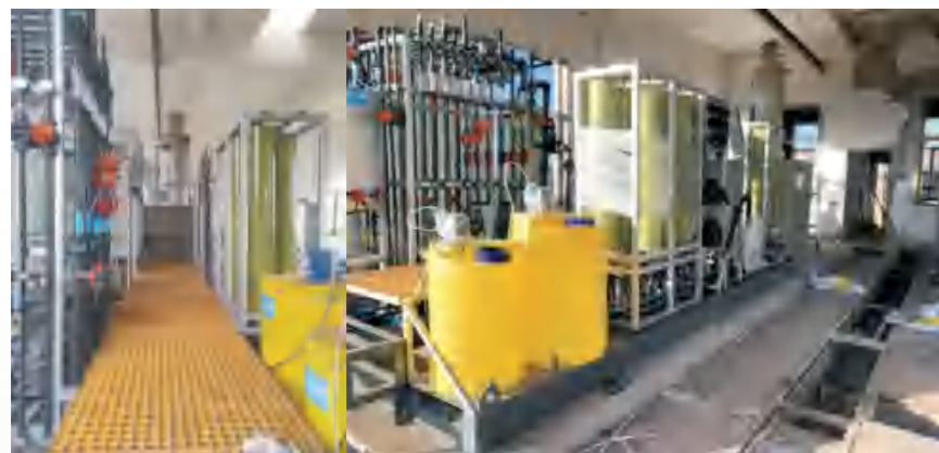
DTRO应用—15m 3 /d张掖市垃圾渗滤液处理
