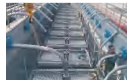
中空纤维膜应用—5000m³/d 市政污水处理
