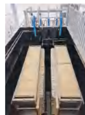
FMBR应用—1000m³/d 泸州工业废水处理
