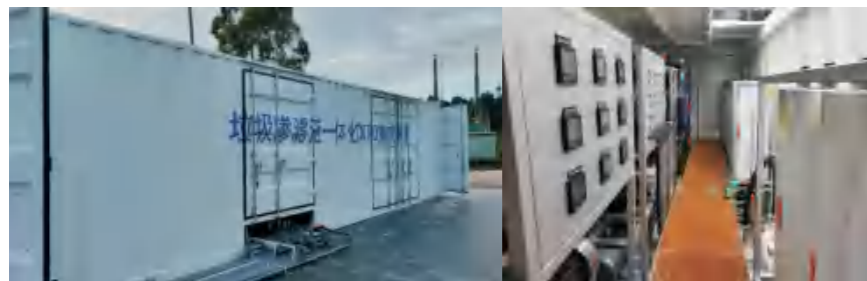
DTRO应用—150m 3 /d广东垃圾渗滤液处理
