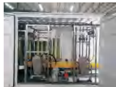
DTRO应用—50m 3 /d米易垃圾渗滤液处理
